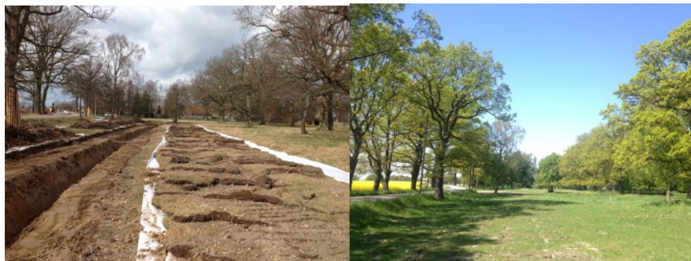
Bilderna är tagna från kabelförläggning när elförbindelsen NordBalt byggdes. Foto: Svenska kraftnät.
